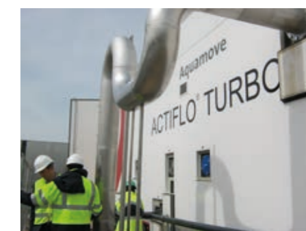
Couplage décantation physico-chimique - charbon actif (Veolia)
