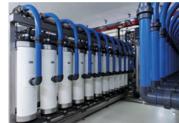
Traitement membranaire en eau potable - Usine de Lutry
