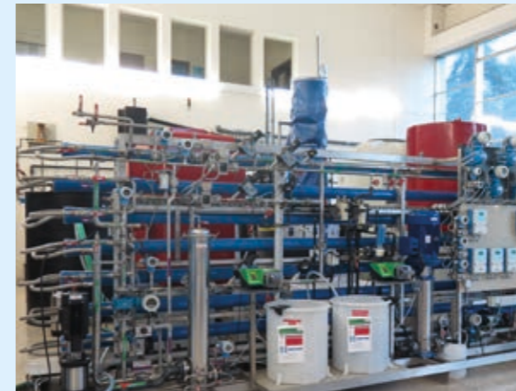
Pilote nanofiltration - Ville de Lausanne
